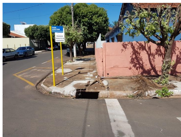
Foto 6.15 – Estrutura de microdrenagem insuficiente
