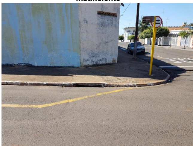
Foto 6.16 – Boca de lobo subdimensionada
