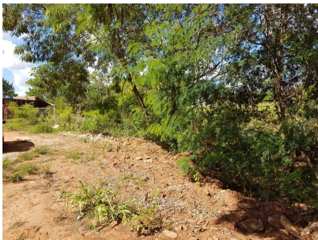
Foto 6.24 – Erosão causada pelo escoamento superficial
