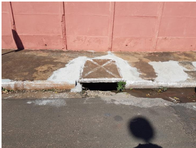
Foto 6.14 – Estrutura de microdrenagem insuficiente
