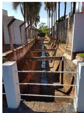
Foto 6.13 – Canal ao lado da prefeitura por onde a água escoar sem problemas
