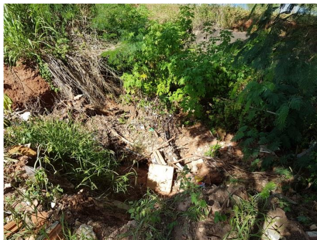
Foto 6.25 – Erosão causada pelo escoamento superficial
