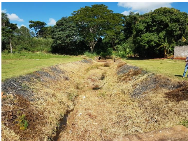
Foto 6.22 – Canal a céu aberto com necessidade de limpeza
